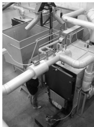
Kotłownia osiedlowa 2x350 kW
