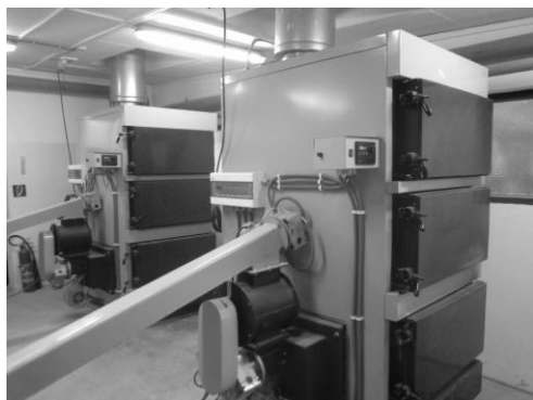
Kotłownia 2x350kW w szkole gastronomicznej
